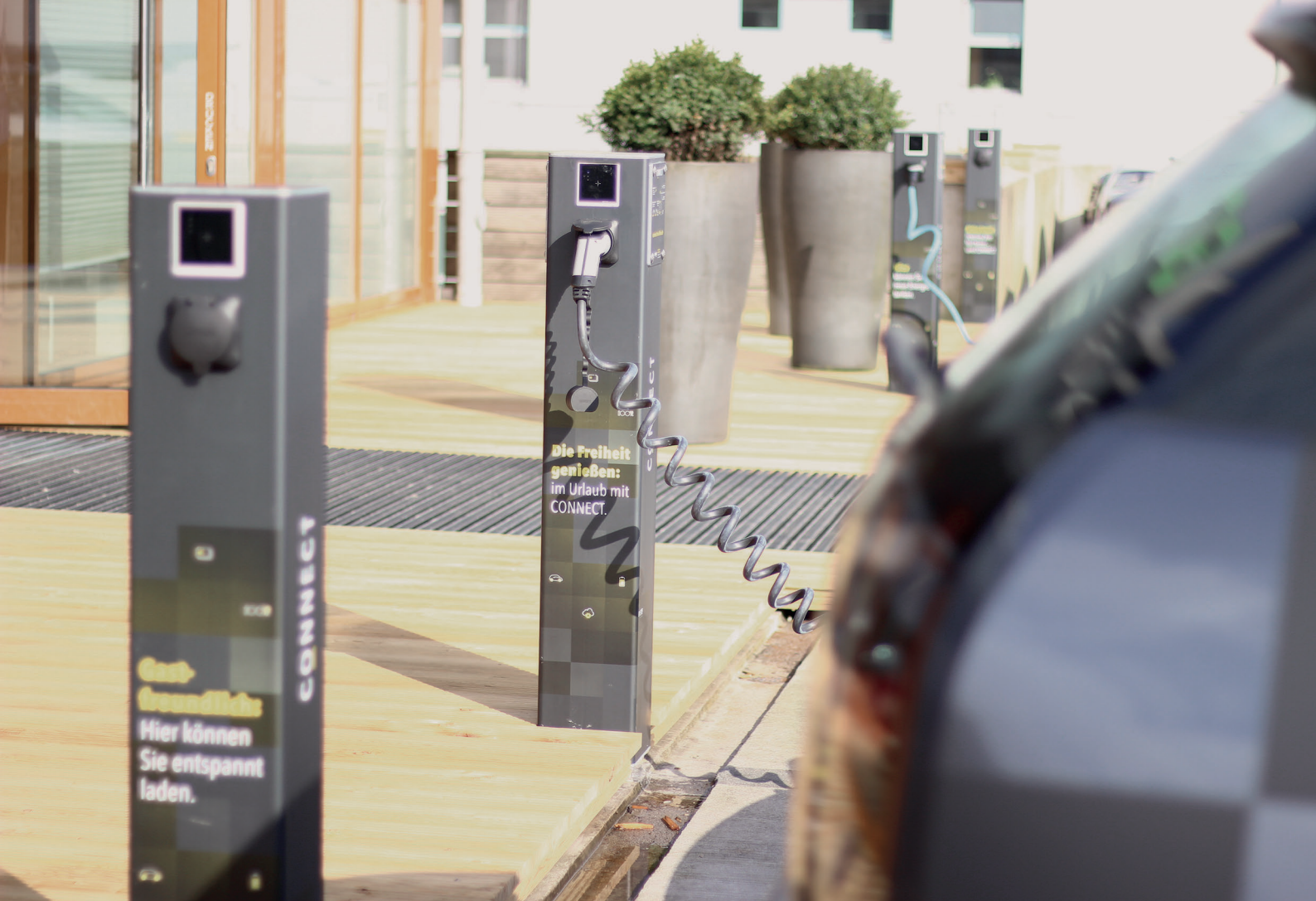
Mithilfe des CLS-IoT-Gateways und der EMT-Plattform von Zenner lassen sich Ladesäulen künftig netzdienlich steuern. Bild: GP Joule
